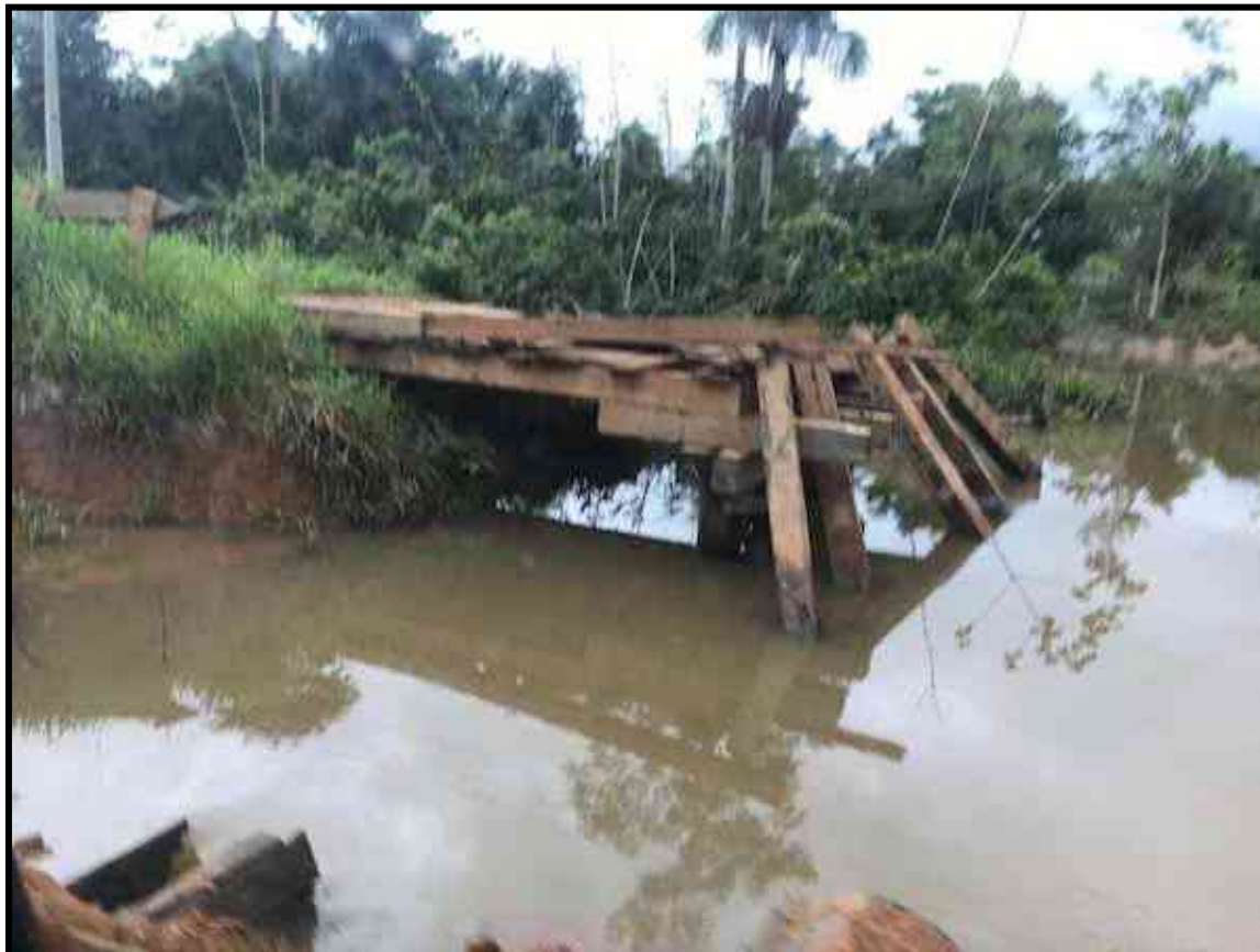
Ilustra ponte desmoronada na Rodovia BR-174.
