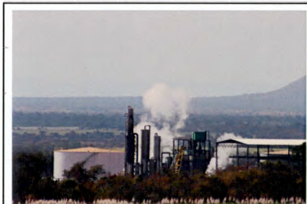
Fig.13 - Equipamento da fase de destilagem
