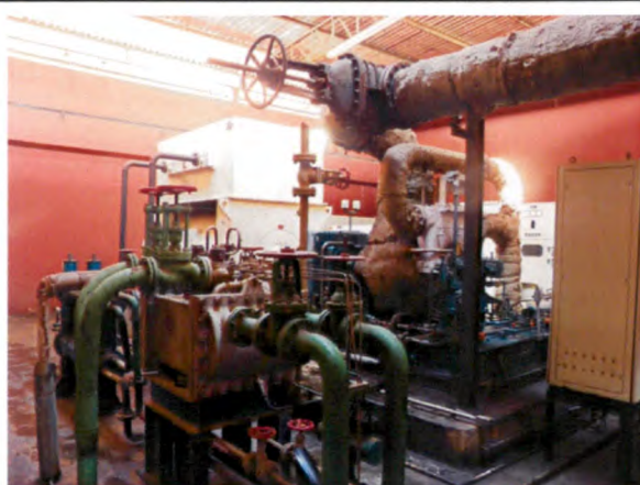
Fig.22 - Equipamento da fase de geração de energia
