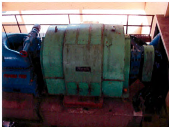
Fig.24 - Equipamento da fase de geração de energia
