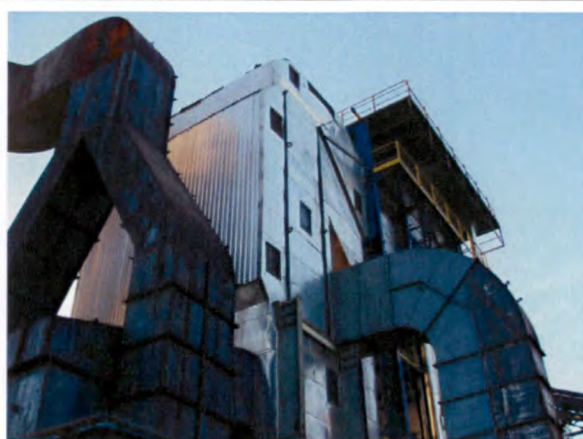
Fig.18 - Equipamento da fase de caldearia
