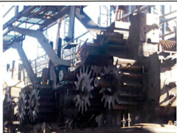
Fig.10 - Engrenamento dos ternos em verificação
