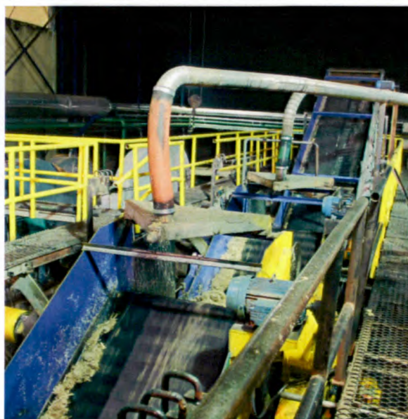
Fig.6 - Equipamento da fase de moagem
