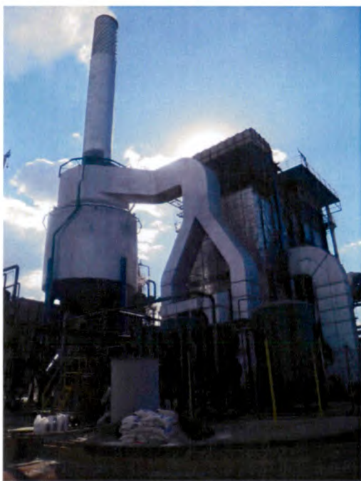
Fig.19 - Equipamento da fase de caldearia
