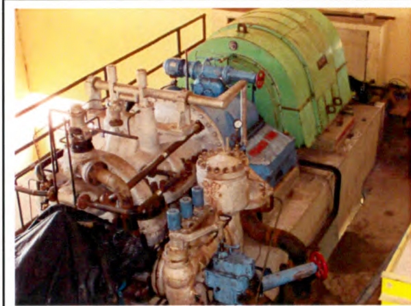
Fig.25 - Equipamento da fase de geração de energia
