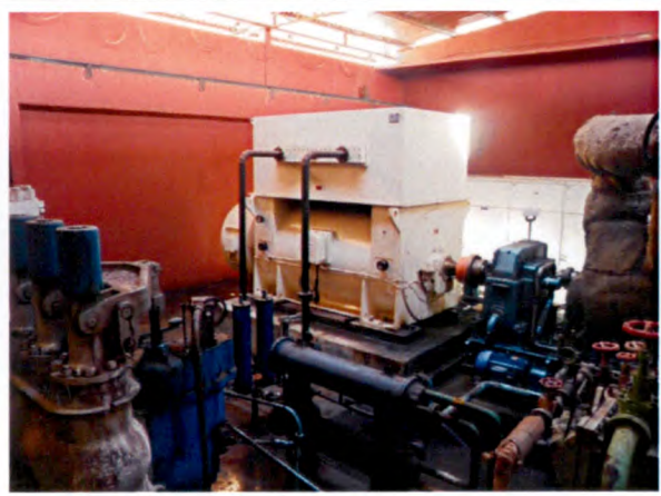
Fig.26 - Equipamento da fase de geração de energia
