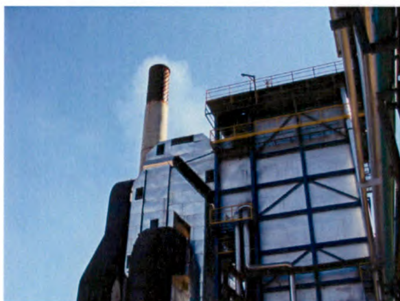
Fig.20 - Equipamento da fase de caldearia
