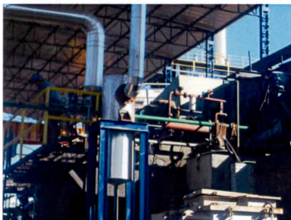
Fig.8 - Equipamento da fase de moagem
