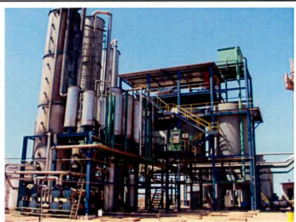
Fig.12 - Equipamento da fase de destilagem
