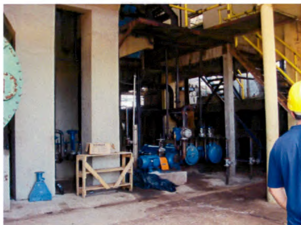
Fig.23 - Equipamento da fase de geração de energia
