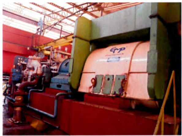
Fig.28 - Equipamento da fase de geração de energia
